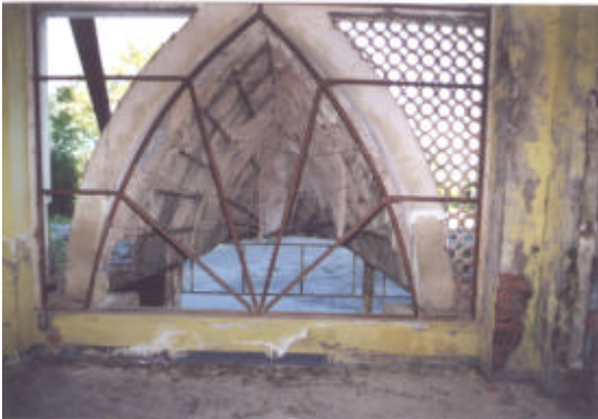
Foto 13 Una delle vetrine che sovrastano l'ingresso dei negozi del colonnato, quasi completamente rovinata dal tempo, dall'incuria e dall'abbandono
